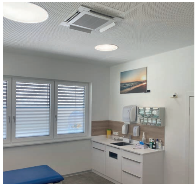
Ordinácia Groß St. Florian, Cool Company Kälte - Klima - Gastro
