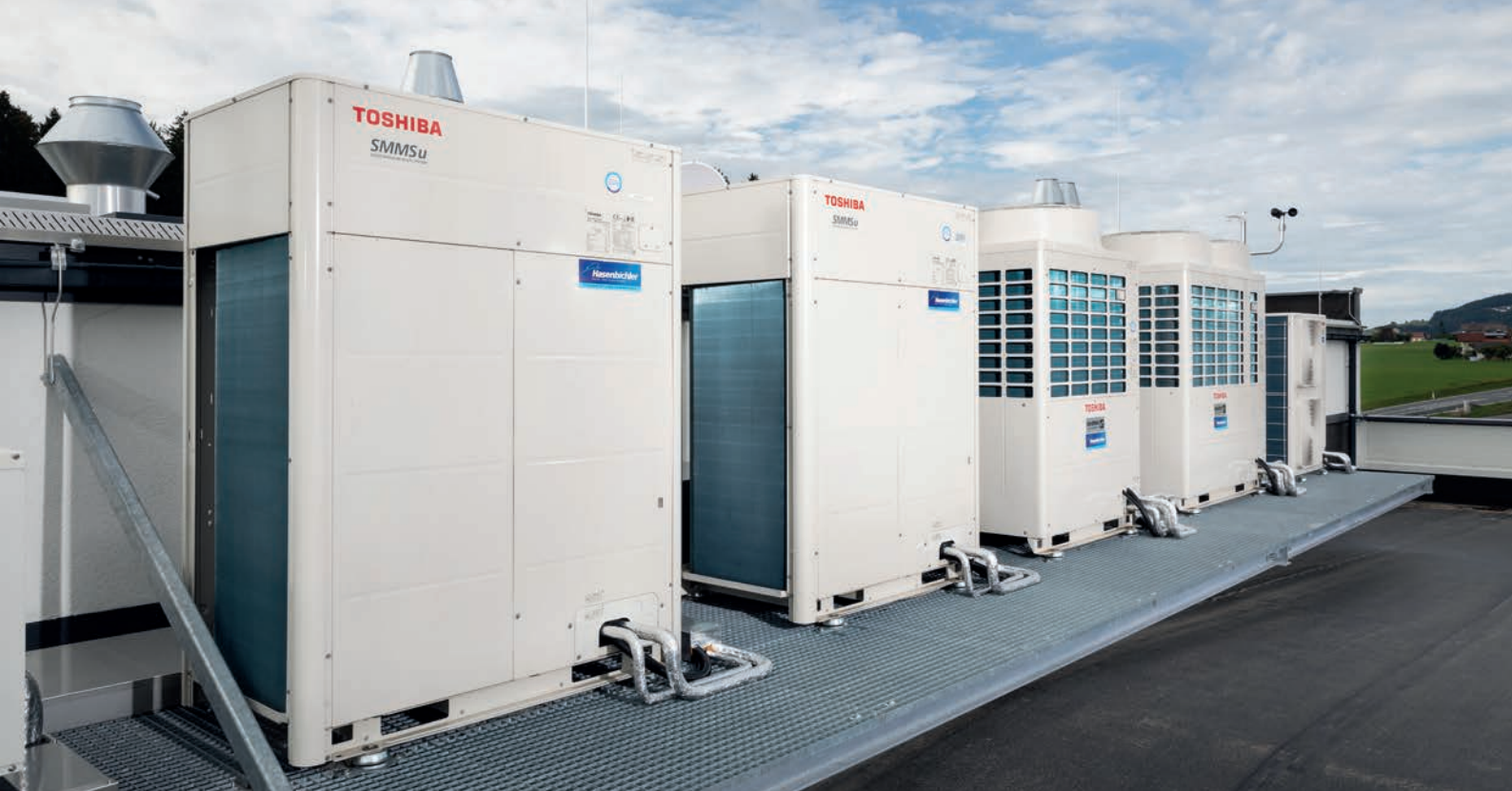
Gishamer Maschinenbau GmbH Friedburg, Hasenbichler Kälte- und Klimatechnik
